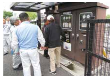
【ポンプ場で操作手順を確認】
