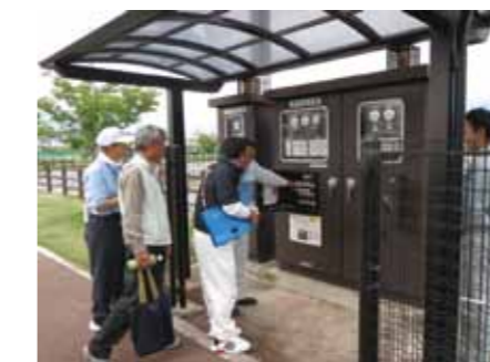
排水ポンプ操作の講習
